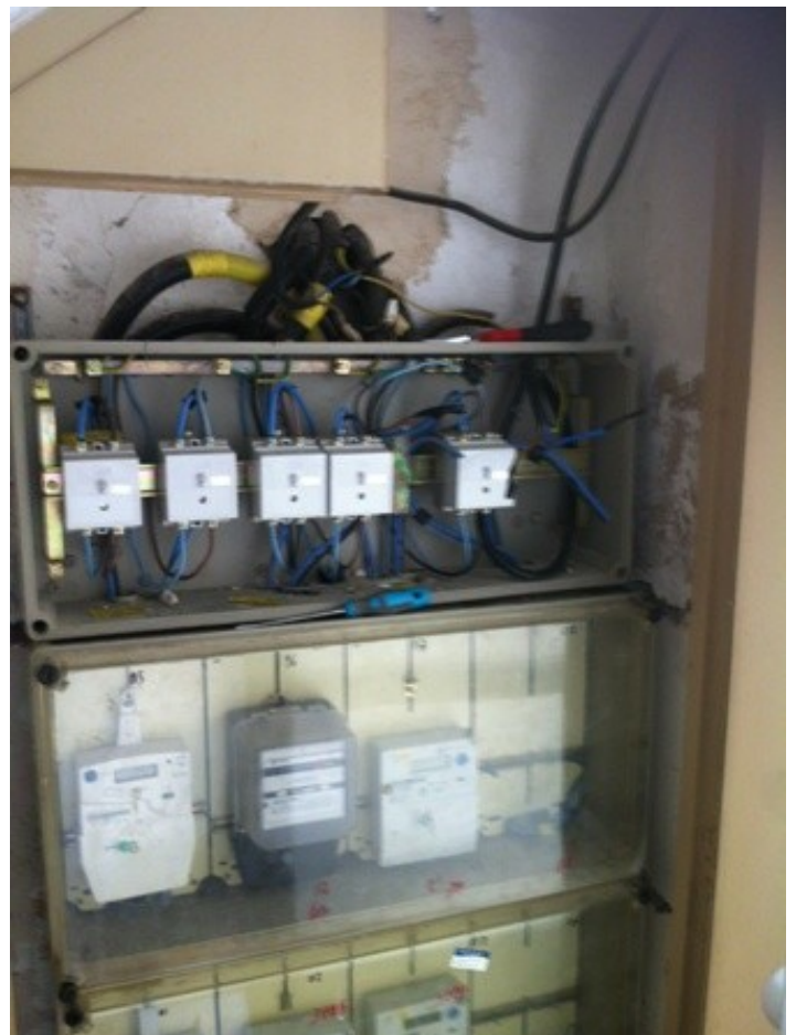
Foto : Instalaciones defectuosas de contadores eléctricos
